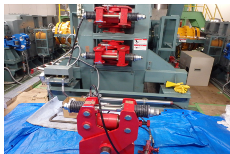
立山ケーブルカー非常制動装置分解整備
