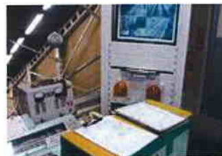
美女平運転室 (パトランプ設置)
