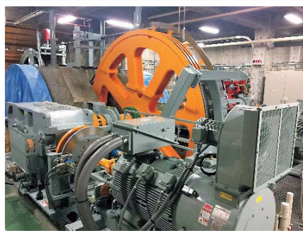
新しくなった原動装置
